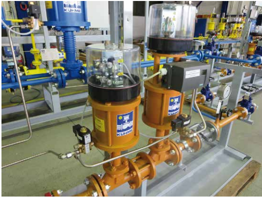
Abb. 5: Öl-Kombination mit Hybridventil in einer Brennerstation (Quelle: KÜHME Armaturen GmbH)
