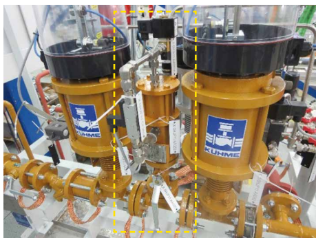
Abb. 2: Automatische Dichtheitskontrolle für flüssige Brennstoffe an einer Schnellschlussventil-Kombination (Quelle: KÜHME Armaturen GmbH)
